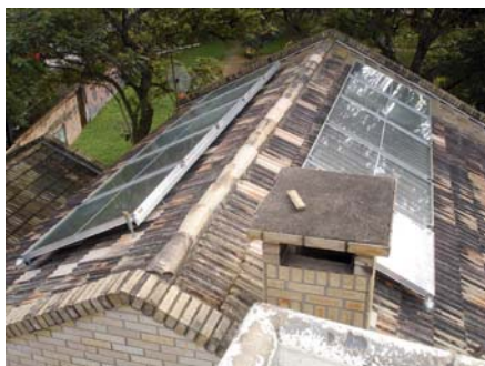
Figura 28 - Painéis solares da Zonal Centro (Fonte: CRER)
