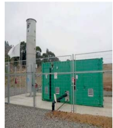
Figura 22 - Unidade de valorização do biogás de aterros para a produção de energia elétrica (Fonte: Engebio)
