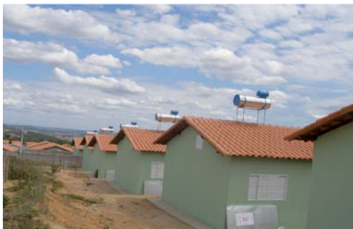
Figura 30: Instalação de Aquecedores Solares em Conjunto Habitacional em BH (Fonte : ICLEI, 2010)
