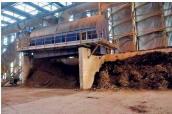
Figura 23 - Unidade de compostagem (Fonte: Engebio)
